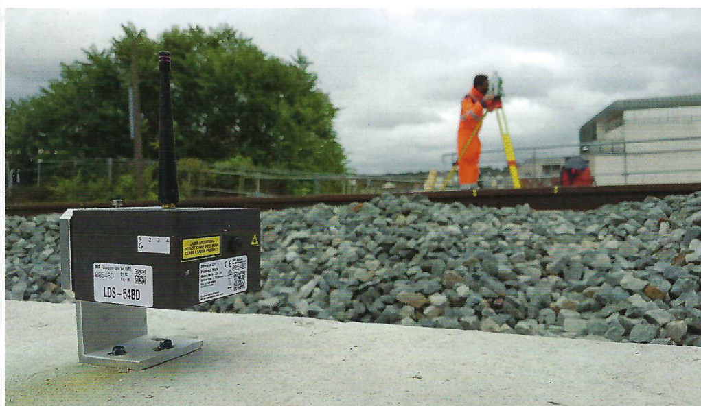
Bild 16: Kombination von Wireless Condition Monitoring mit klassischen, vermessungstechnischen Verfahren ermöglicht zeitlich dichte Beobachtung und effiziente Ressourcennutzung
