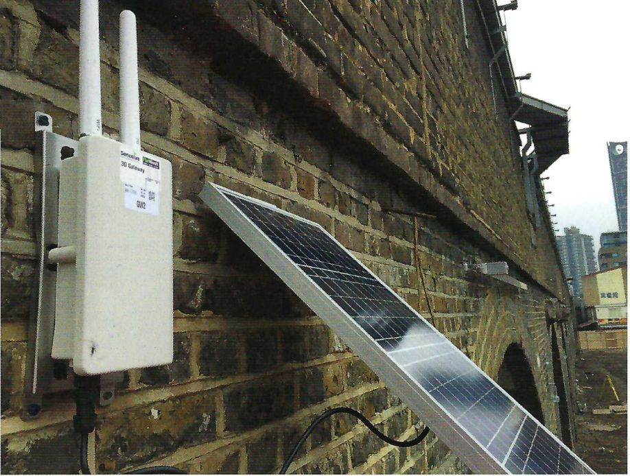
Bild 4: Mobilfunk-Gateway mit Solarpanel zur autarken Stromversorgung
