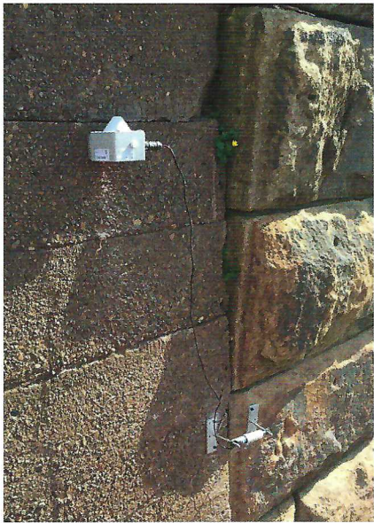
Bild 3: 1D-Cracksensor, angeschlossen an einen drahtlosen Datenknoten
