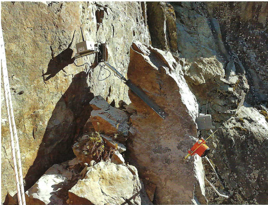
Bild 6: Überwachung von Felsbewegungen mittels Crackmeter (an drahtlosem Node) und 3-Achs-Neigungssensor
